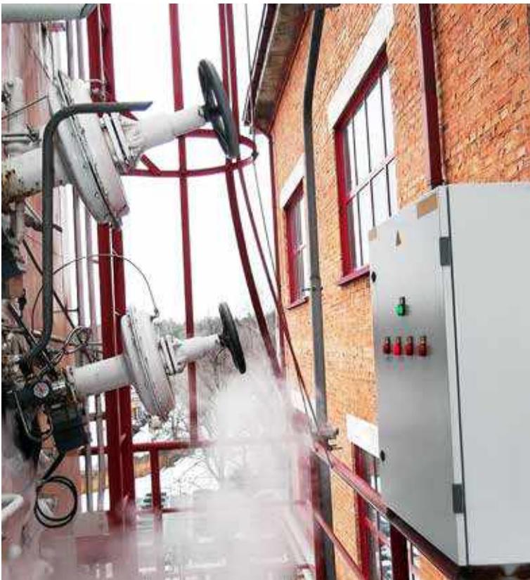
Рисунок 3. Общий вид электрощита блока управления нагревом.
