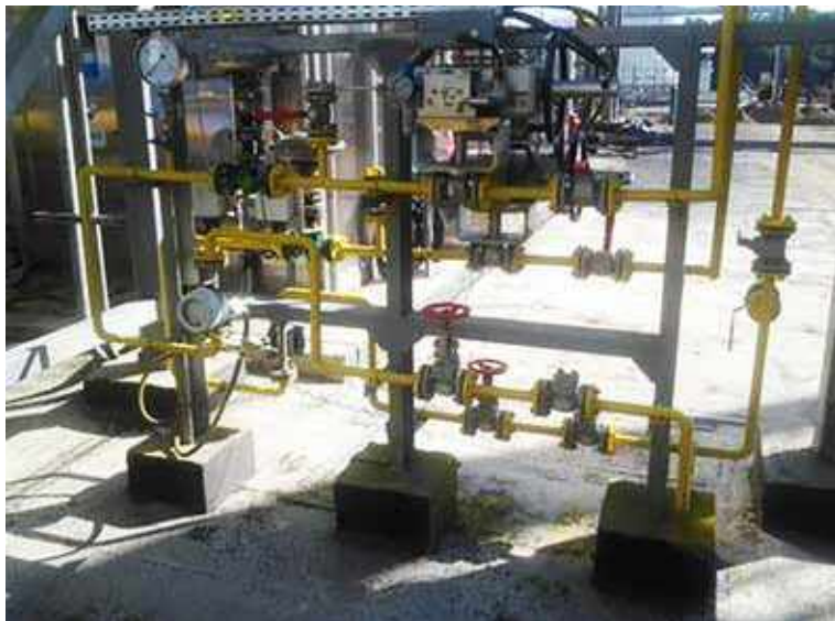
Фото участка обогреваемого трубопровода.
